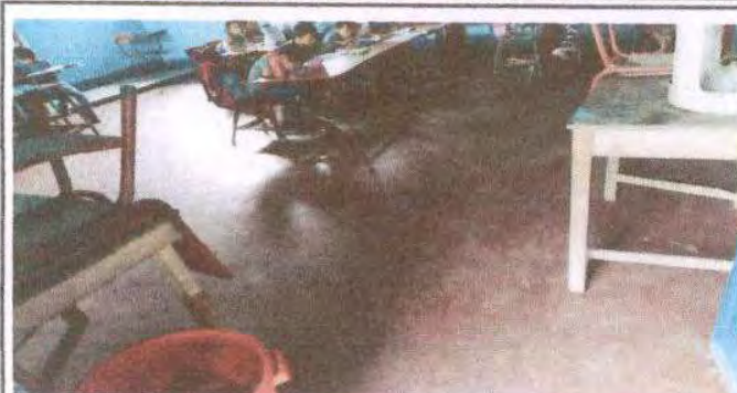
Foto 20: En aula 3, se colocará piso cerámico debido al deterioro del piso liso. Total de metros 52 m 2 .
