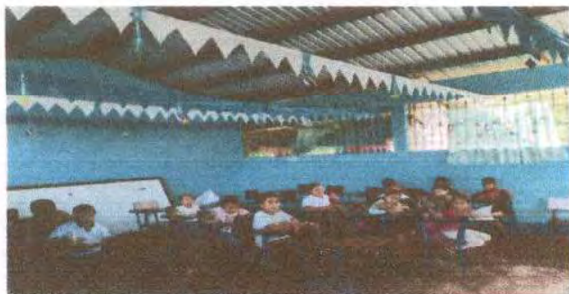
Foto 13: Pintura de aula 1, se pintará debido al tiempo y falta de pintura en algunos segmentos de la pared. Total de metros 99 m 2
