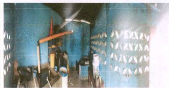
Foto 4: Este espacio corresponde a la cocina escolar, ha generado problemas con el humo cuando se cocina, por falta de ventilación, necesitamos instalar balcones a la altura de la celosía haciendo un total de 10 m 2 . (10mx1m)
