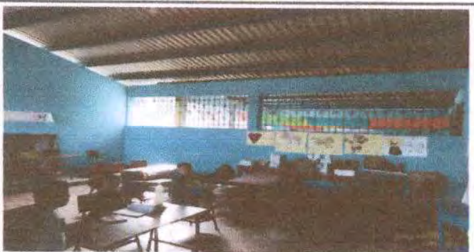
Foto 21: Pintura de aula 3 se pintará debido al tiempo y falta de pintura en algunos segmentos de la pared. Total de metros 99 m 2 .
