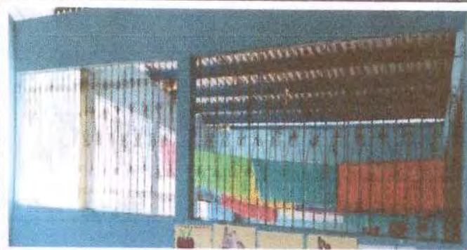
Foto 19: Mantenimiento a balcones de metal por deterioro en pintura, aula 3, total de metros 12, son dos lados de 6 metros cada uno.
