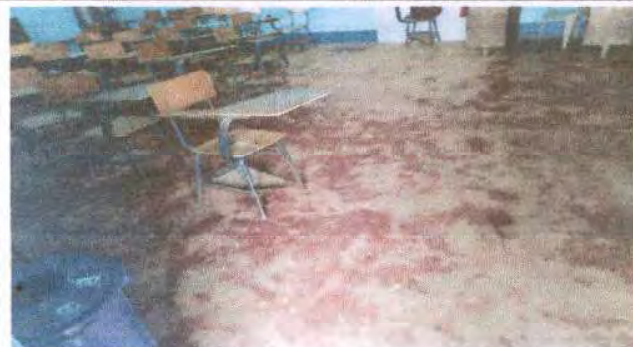
Foto 16: En aula 2, se colocará piso cerámico debido al deterioro del piso liso. Total de metros 52 m 2 .
